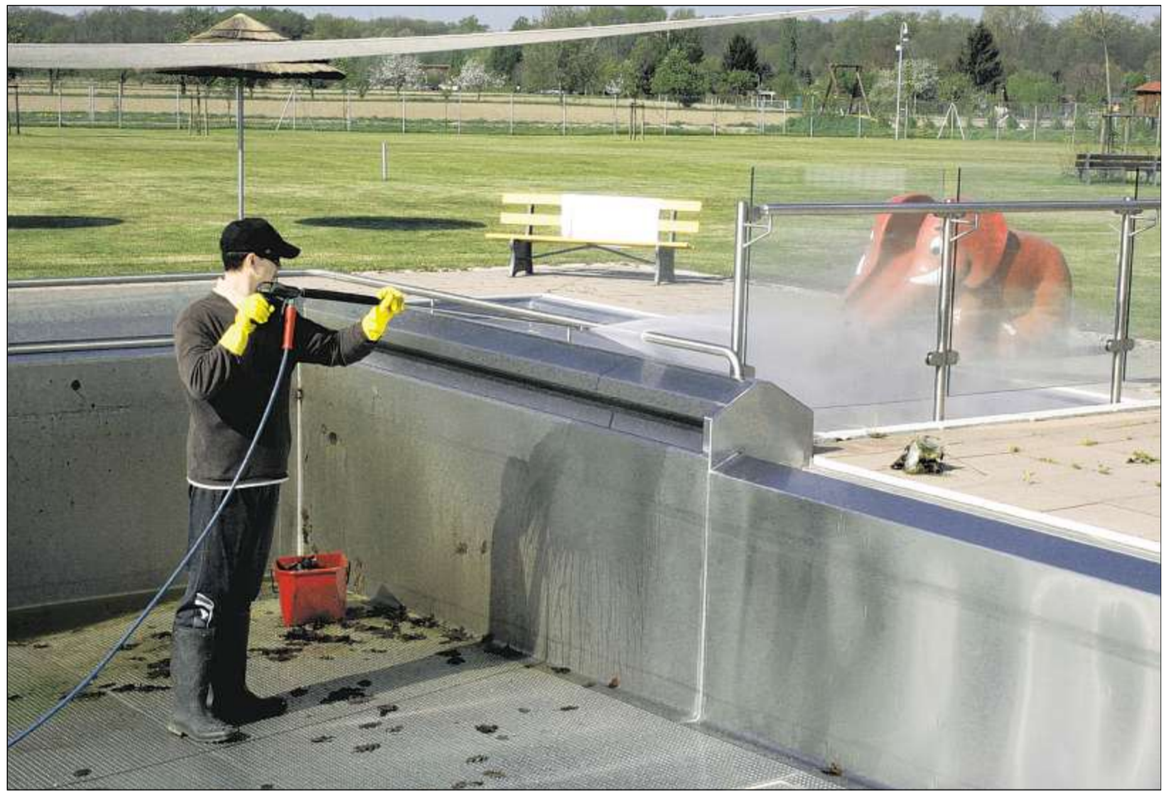
MIT DEM HOCHDRUCKREINIGER rückt Victor Retznikov im Weingartener Freibad Schmutz und Algen zuleibe. Zu den Vorbereitungen gehört auch, die Filter zu reinigen und den pH-Wert zu kontrollieren.
