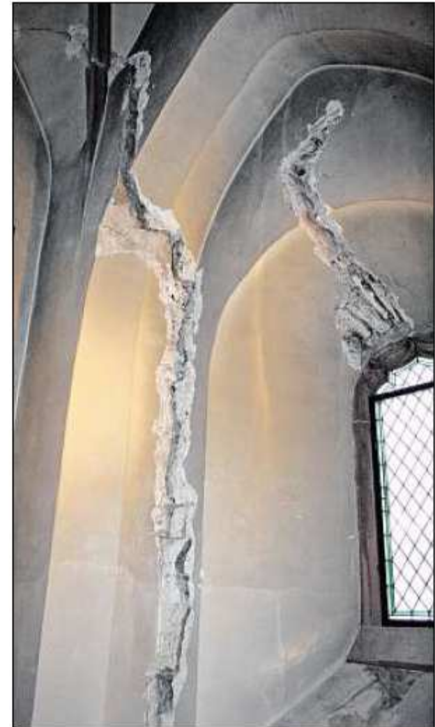
FREIGELEGT wurden die Risse – hier an der Fensterlaibung – in der Kirche. Foto: Lothar
