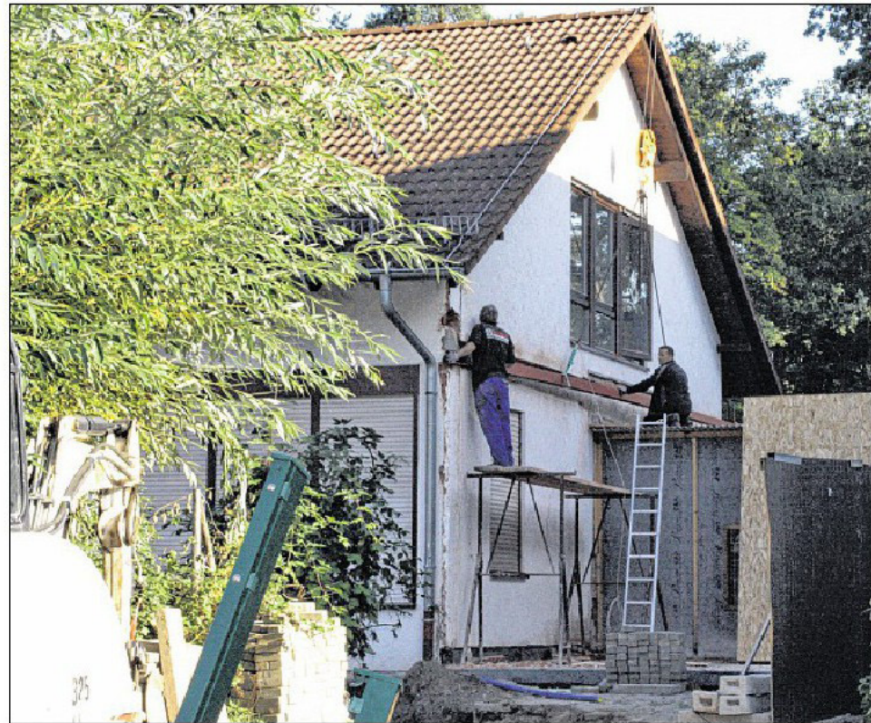
FÜR DIE BAUARBEITEN am Kindergarten Waldbrücke in Weingarten wurden an der Fassade des Altbaus Stahlträger befestigt. Foto: Lothar
