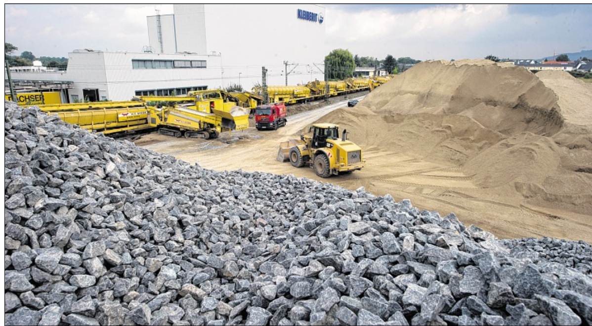
SANDHAUFEN UND SCHOTTERBERG für den Untergrund der Bahnstrecke hat die Bahn südlich von Weingarten geschaffen. Hier wird der Spezialzug befüllt.
