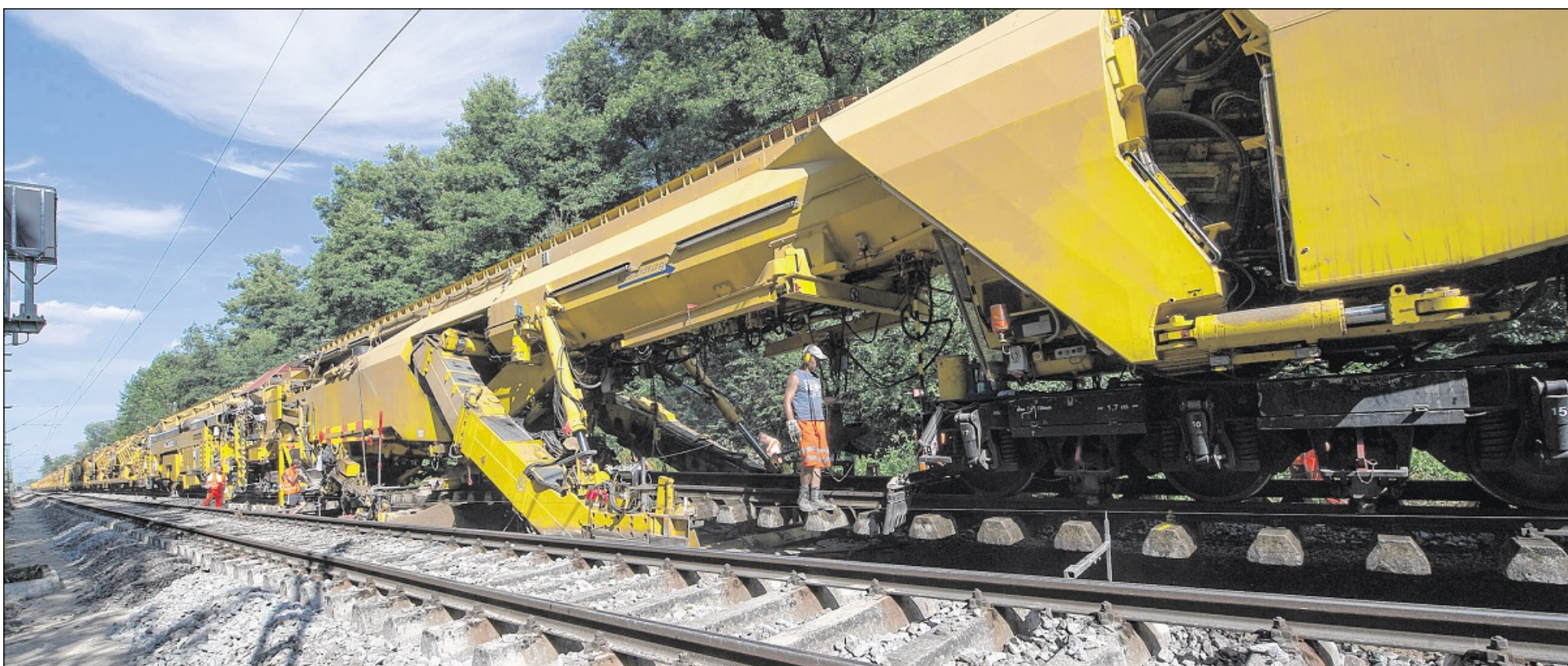
800 METER LANG ist der Spezialzug, der auf der Bahnstrecke zwischen Durlach und Weingarten eingesetzt wird, um das Schotterbett zu erneuern. Die Steine werden vor Ort sortiert und gereinigt. Nicht mehr brauchbares Material kann abgefahren, neues per Bunkerwagen zugeführt werden. Fotos: Alábis
