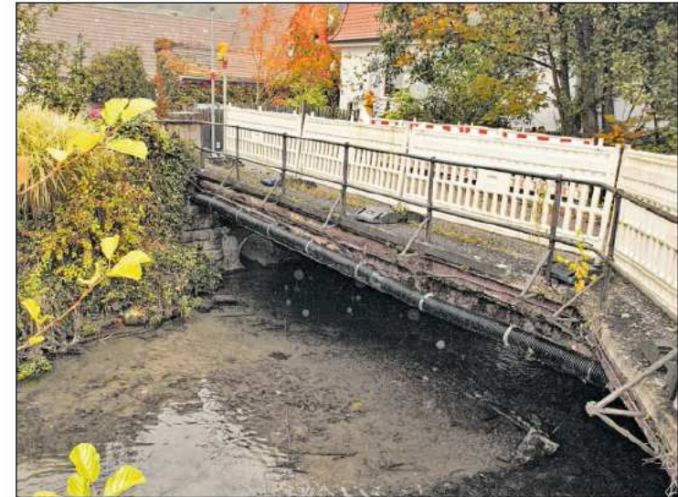
DER ZAHN DER ZEIT hat an der Brücke in der Mühlestraße genagt. Sie wird saniert und erhält ein neues Gelände. Kostenpunkt: rund 500 000 Euro. Foto: Lothar
