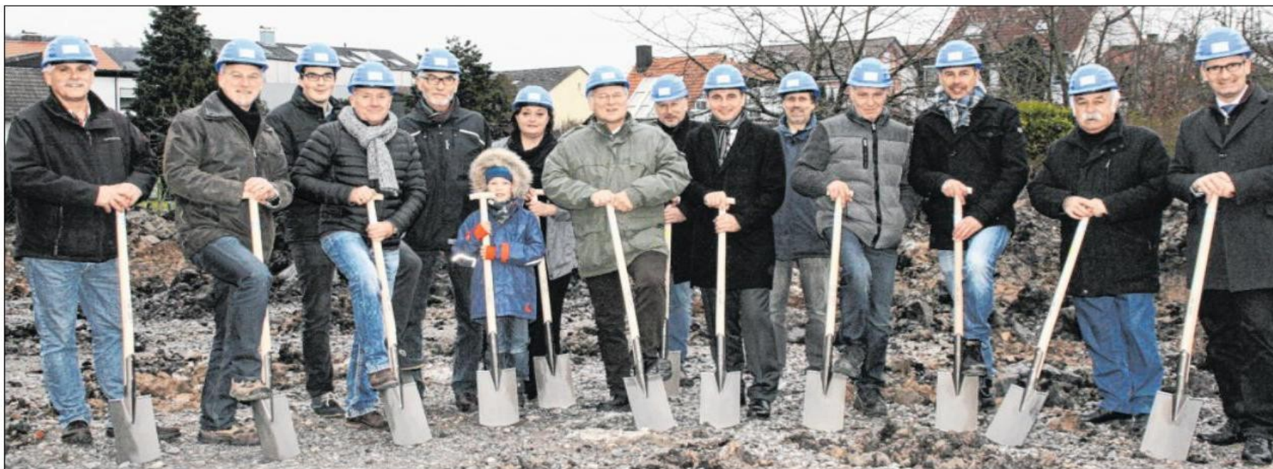
SPATENSTICH IN WEINGARTEN (von links): Dieter Riekert-Mebus und Bernd Hauck (Tragwerksplanung), Thomas Becker, Torsten Hill (Planung und Projektleitung), Siegfried Pollak, Marion Werner (Aufsichtsrätin), Klaus-Dieter Scholz (Vorstandsvorsitzender), Thorsten Reinschmidt, Juan Baltrock (Volksbank Stutensee-Weingarten), Günter Roth, Gerald Sütsch, Michael Weickum (Aufsichtsratsvorsitzender), Willi Erkmann, Eric Bänziger (Bürgermeister). Foto: Lothar
