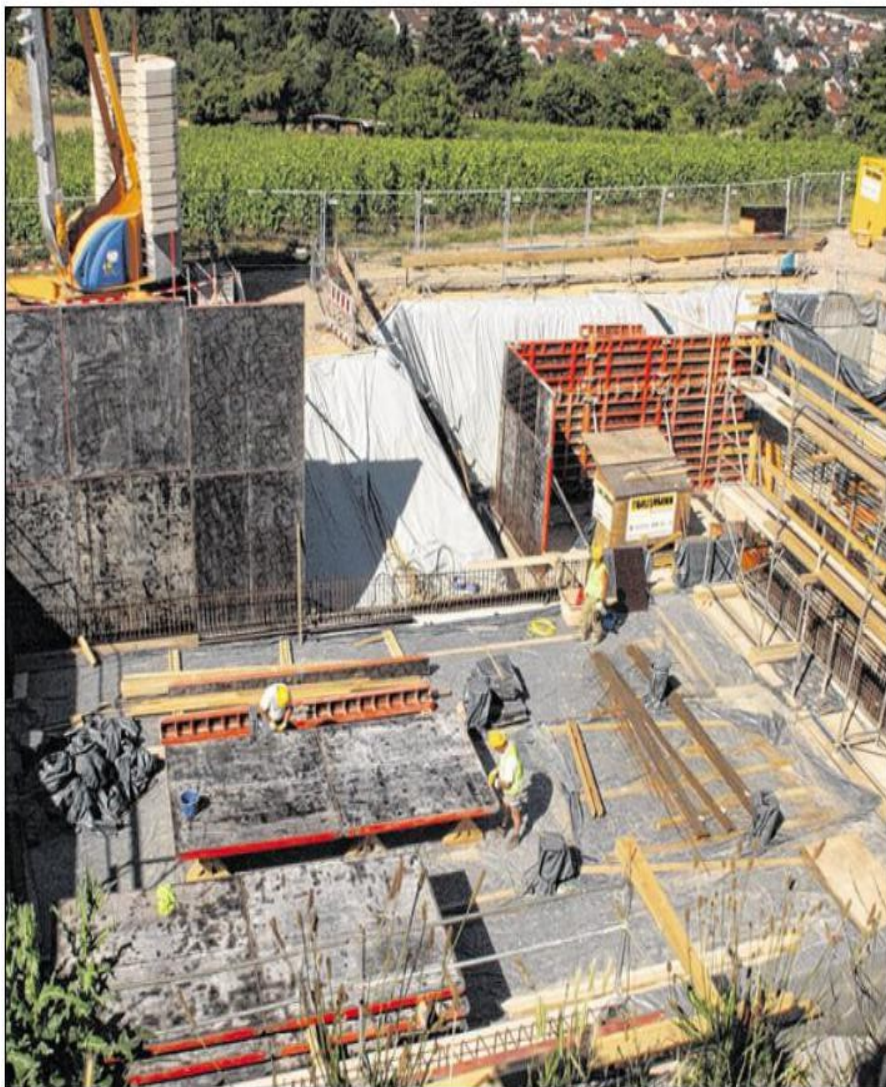
IM WEINGARTENER GEWANN „KATZENBERG“ entsteht der Neubau eines Wasserhochbehälters. Besonderes Augenmerk gilt den hygienischen Anforderungen. Foto: Lothar
