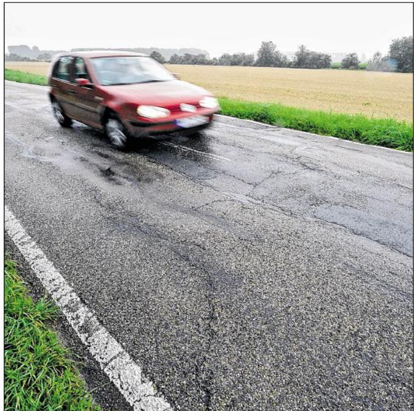
IN EINEM BESCHEIDENEN ZUSTAND befindet sich die Landesstraße zwischen Rußheim und Huttenheim – sie soll saniert werden. Foto: Alábliso
