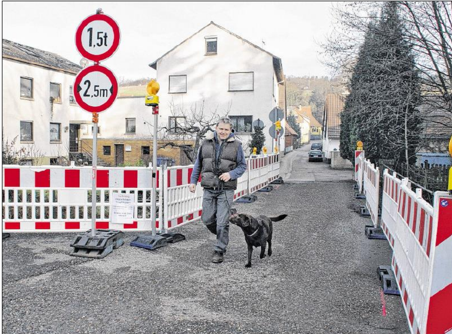
MIT SICHERHEITSAKEN ABGESPERRT ist die Brücke, die in Weingarten die Mühlstraße mit dem Schmalensteinweg über den Walzbach verbindet. Sie ist nicht mehr sicher und darf daher nur noch mit höchstens 1,5 Tonnen belastet werden. Foto: ml
